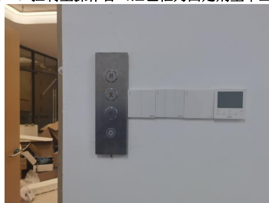
图 2-10 控制室内防护门紧急开门按钮及停机按钮
