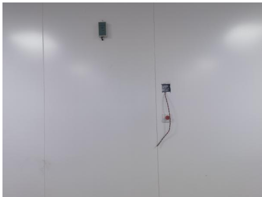
图 2-11 机房南侧墙固定式探头及紧急停机按钮
