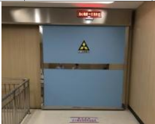
图 2-7 机房防护门及警示标语
