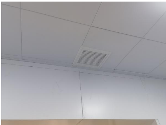
图 2-17 机房内进风口
