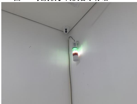
图 2-9 控制室摄像头及剂量率报警装置
