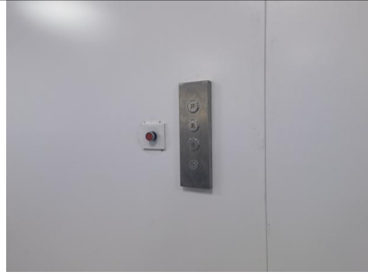
图 2-14 机房西侧墙紧急停机按钮及防护门开门按钮
