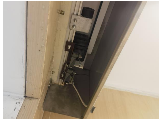
图 2-16 机房防护门联锁装置
