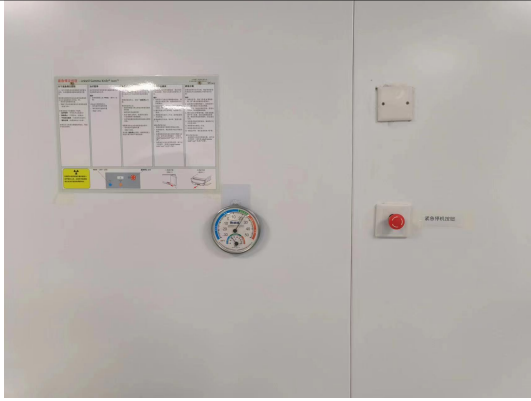
图 2-13 机房东侧墙紧急停机按钮
