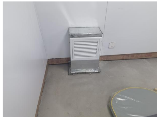
图 2-18 机房内排风口
